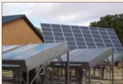
Figura 6. Vista de los frigoríficos solares y el seguidor solar fotovoltaico
